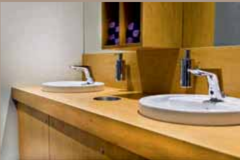
Waschtischanlage für ein Landhotel
